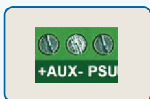
Wyjścia techniczne typu OC, PSU (AW) - awaria przetwornicy
